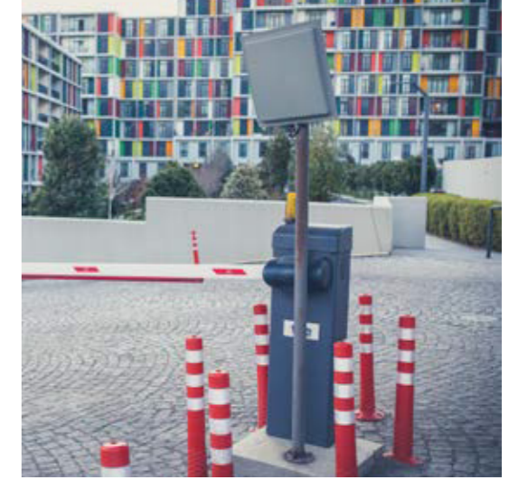
Hızlı Geçiş Sistemleri
